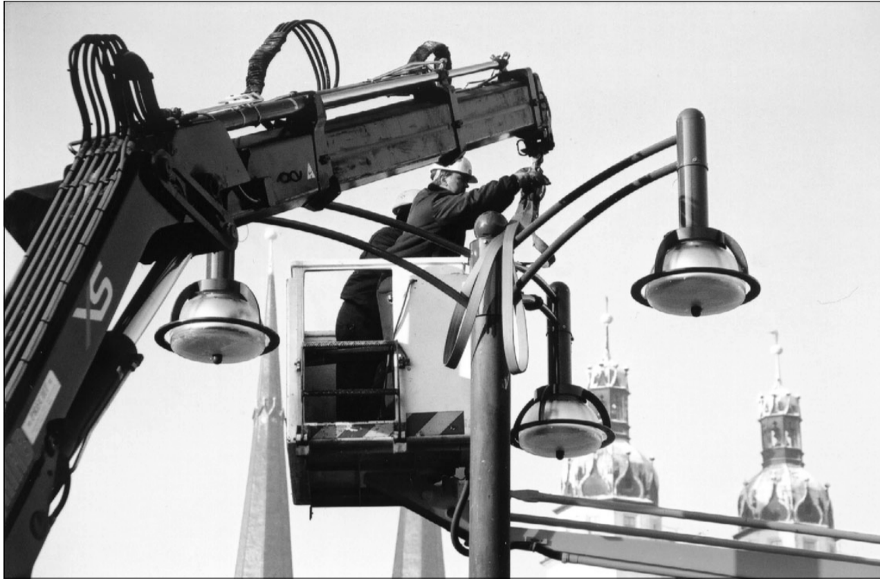
Mitarbeiter der Firma Elektro-Bohndorf waren diese Tage dabei, die alten gläsernen Kugelleuchten auf dem Marktplatz durch moderne Lichtquellen zu ersetzen. An insgesamt sechs Masten mit je drei Leuchten wurden Aludruckguss-Leuchtkörper installiert. Foto: Th. Ziegler
