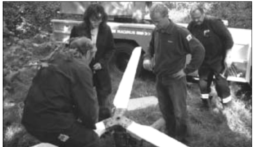
Ende September war mit Hilfe der Berufsfeuerwehr Halle das im Juni demontierte Windrad im Schulumweltzentrum (SUZ) Franzigmark nach erfolgreicher Reparatur des defekten Motors durch den Windradbetreiber Enercon Magdeburg wieder an seinen alten Platz gehoben worden. Im Beisein von Dr. Thomas Katterle und Andrea Rust vom Fachbereich Umwelt der Stadtverwaltung und einer Grundschulklasse, die sich zum Ökologieunterricht im SUZ aufhielt, sowie von SUZ-Mitarbeitern wurde das Windrad in 15 Meter montiert. In einer Messstation werden nun wieder die Messdaten der Stromgewinnung und die Windstärken abgelesen. Foto: H. Reinelt
