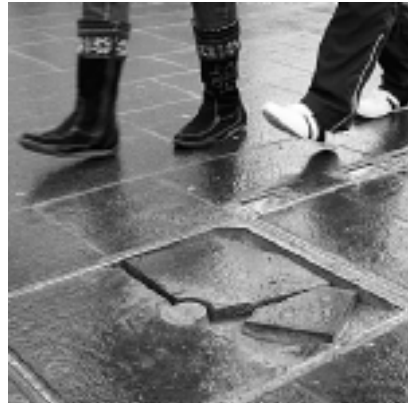
Deutlich sichtbar sind die Schäden auf dem Marktplatz. Foto: T. Ziegler
