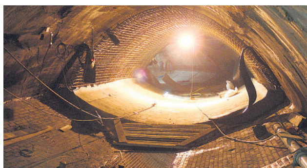
Im Vordergrund sind noch die Ziegelsteine des Gewölbes zu erkennen. Im Hintergrund schiebt sich die Betonschicht nach vorn.
