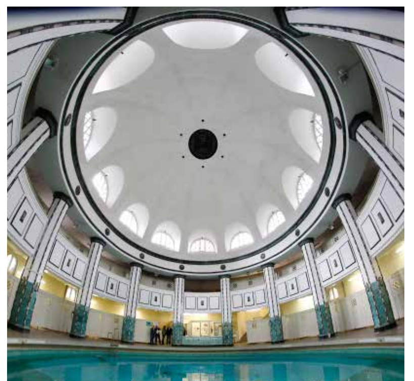
Die „Rabitzdecke“ der Frauenhalle des halleschen Stadtbades soll bis Juni 2014 saniert werden. Foto: Steffen Schellhorn
