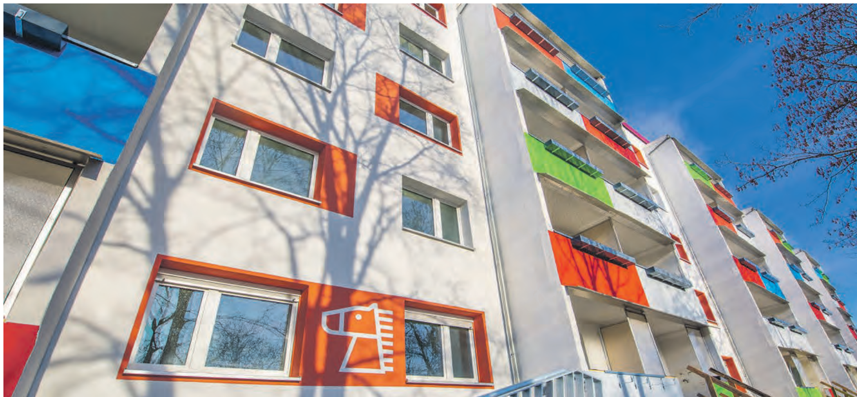
In der Trakehnerstraße 47-55 hat die GWG die Fassadenarbeiten bereits abgeschlossen. Im Frühjahr sollen die Wohnungen bezugsfertig sein.
