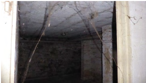
1c. Spinnweben an der Decke eines Kellerraums
