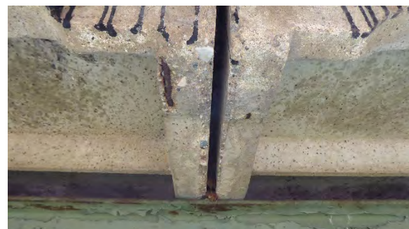
5b. Lücke zwischen Dachsegmenten (außen)
