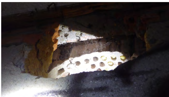
12e. Loch im Mauerwerk innerhalb einer Zwischenwand
