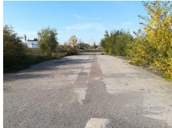
Abbildung 12: große versiegelte Fläche im inneren des Plangebietes (Foto: Büro Schulz UmweltPlanung, 15.10.2019)
