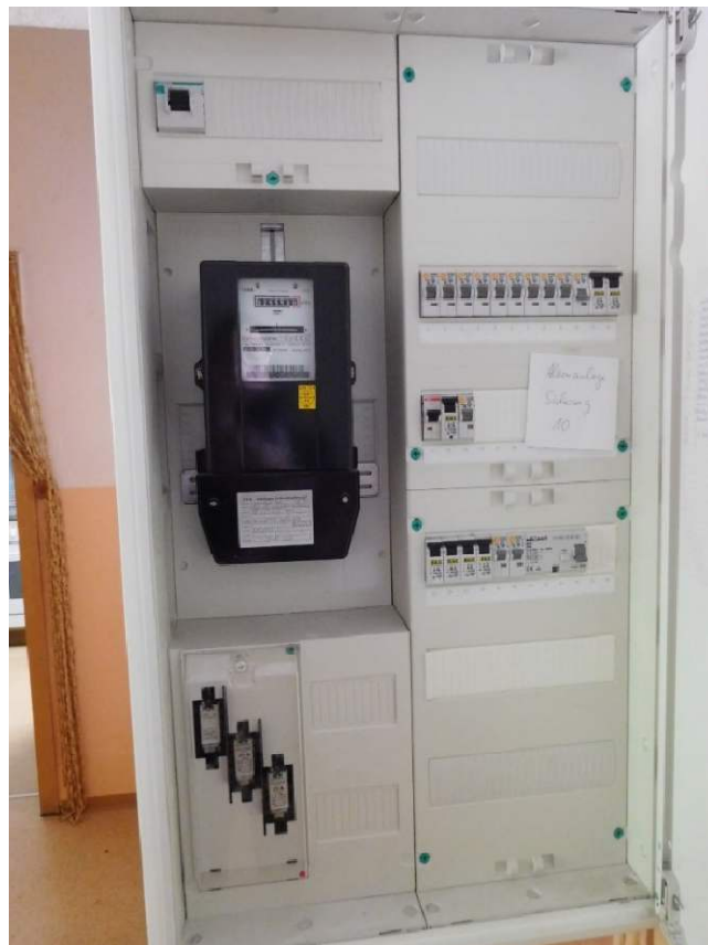
Sicherungs,- Zählerkasten (Strom)
